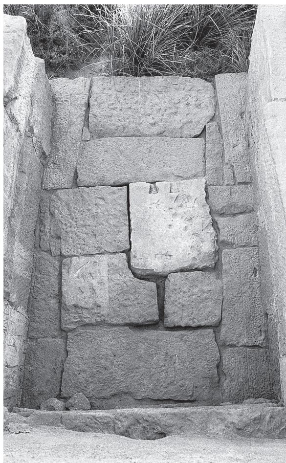
Photo 3. Karnak-Nord. Temple d'Aménophis III. Porte ptolémaïque du temple. Première assise de fondation de la porte, au centre, le bloc n° 5a in situ (vue prise vers le sud).
