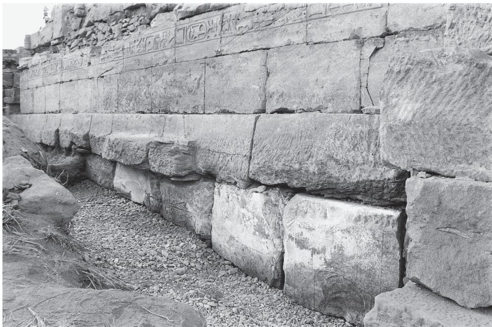
Photo 1. Karnak-Nord. Temple d'Aménophis III. Façade de la cour à péristyle, moitié est : blocs de la chapelle d'Hatchepsout remployés en première assise de fondation (vue prise vers le sud-est).
