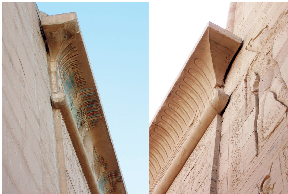
FIG. 12. Détail architectural montrant la désolidarisation de certaines extrémités des corniches avec la paroi. Portes des pylônes de Médinet Habou et de Philae.
