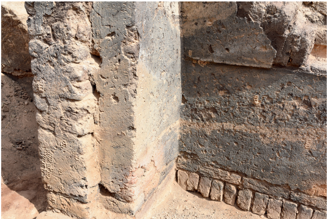
FIG. 19. Vue du corridor 3, de l'angle de la porte 34 et du mur 14, depuis le sud-ouest.
