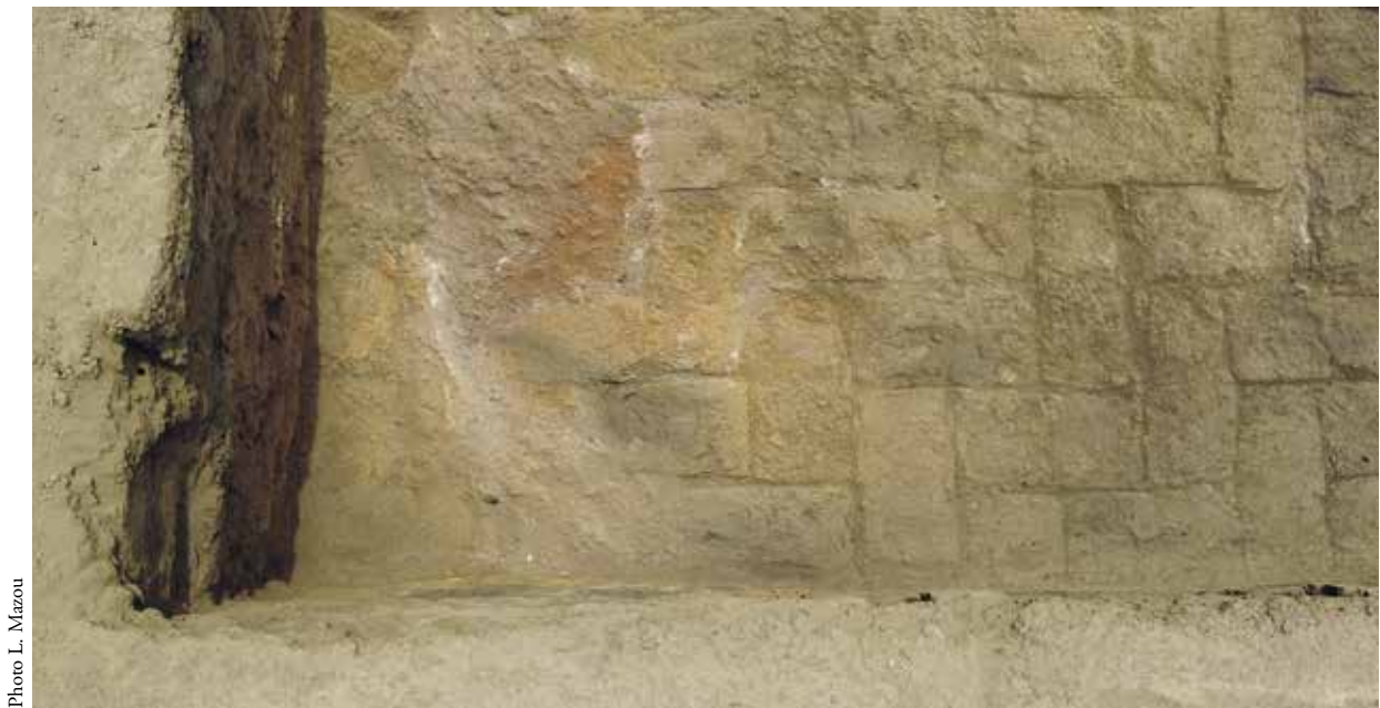
FIG. 9. P18, 2017. Phase 2, bâtiment 5, pièce 8. Traces d'incendie.
