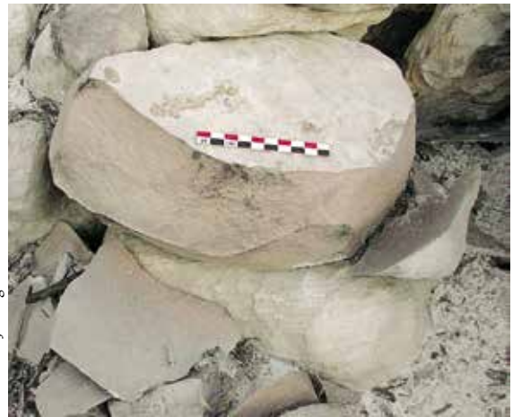
FIG. 2. Pierrier de blocs de calcaire affectés d'un décollement d'écailles thermiques au cours d'un incendie.
