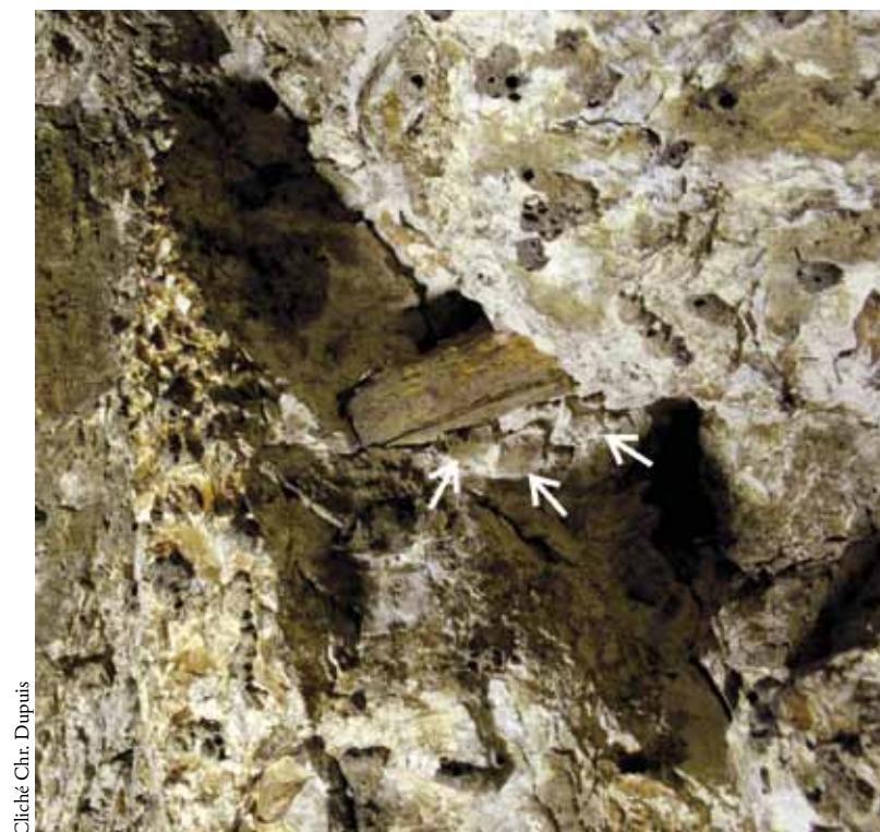
FIG. 22. Cale de bois dans une fracture ouverte du plafond de la deuxième salle de la TT 92. Seuls subsistent quelques éclats de calcaire (flèches) maçonnés contre la pièce de bois, témoins d'un colmatage probablement complet de la fracture ouverte.
