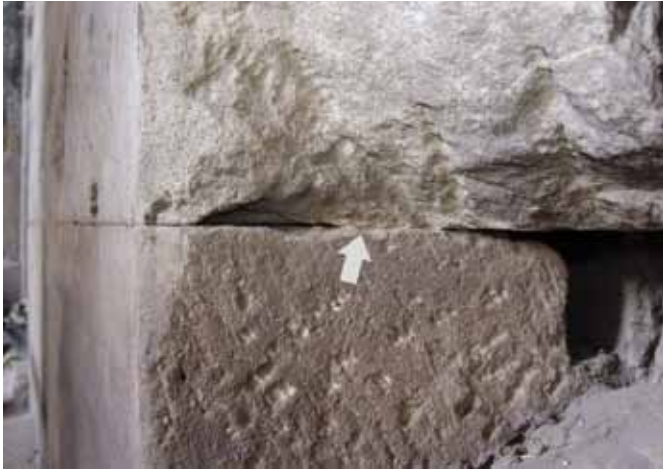
FIG. 12. Vue transversale d'un joint horizontal en l'absence d'un bloc de maçonnerie. On constate qu'il est parfaitement serré du côté du parement et qu'il s'évase légèrement à l'intérieur. La flèche entre les deux faces de joint, bien visible grâce au mortier qui a rempli l'espace, mesure ici environ 3 mm.
