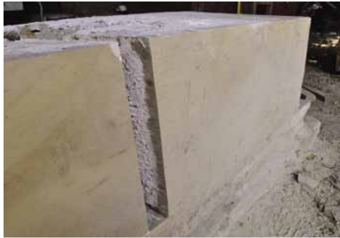
FIG. 28. Ouverture d'un joint montant pour observer la répartition du coulis. On constate que la propagation de celui-ci s'arrête à la limite de la zone sciée, là où le contact des faces de joint est parfait.
