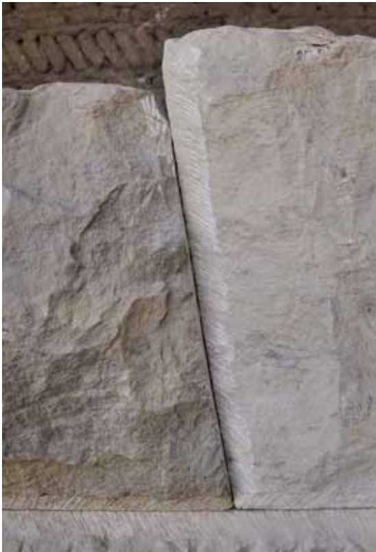
FIG. 18. État du joint avant l'ajustement par sciage.
