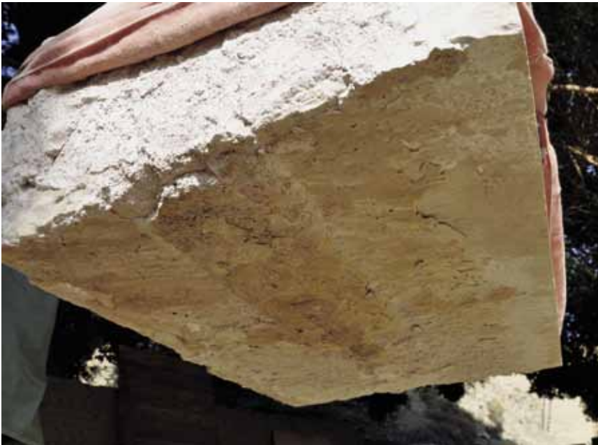
FIG. 30. Le lit de pose après levage du bloc. L'utilisation d'un coulis se reconnaît par l'irrégularité de sa propagation sur sa face de joint. Cet aspect du coulis peut parfois être observé sur des blocs déchaussés de monuments antiques.
