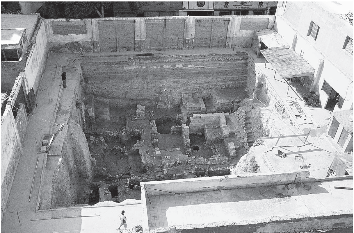
Fig. 13. Alexandrie. Patriarcat grec orthodoxe. Vue générale du chantier (© Fr. Choël, archives CEA).
