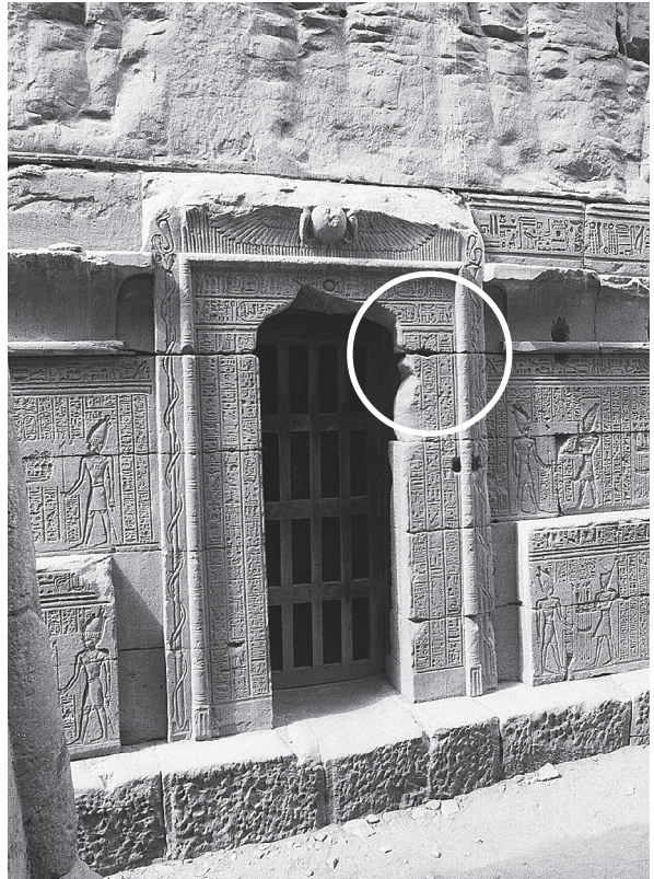
Fig. 29. Temple d'Opet à Karnak, porte dans le soubassement de la façade est avec un joint ouvert entre le linteau et les jambages.
