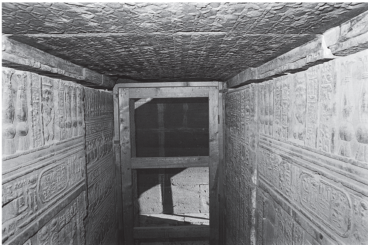
Fig. 16. Dendera, mammisi romain, passage entre la salle des offrandes et le couloir au portique nord, détail du joint ouvert entre les dalles de plafond et les murs.
