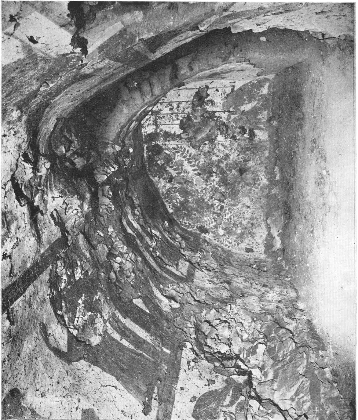
§ 19. — DEIR EL-MÉDINEH, tombe n° 292 : un monument, parmi tant d'autres, dont la conservation pose de difficiles problèmes (Cliché Et. Revault).
