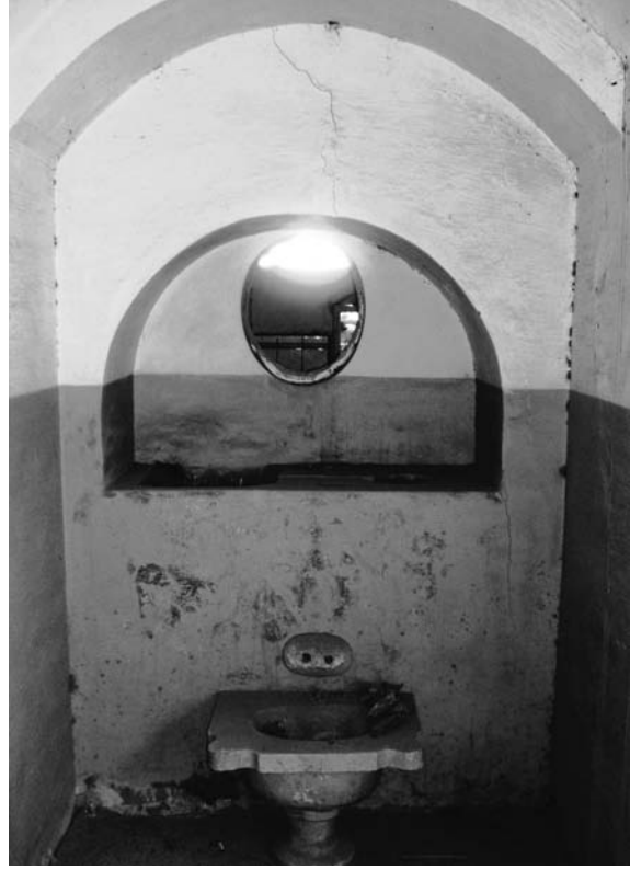
لوحة (١). قصر بن سليمان بجبره: الطابق الأرضي، الحمام، الحجرة الساخنة، الدخلة الشمالية، ويلاحظ حوضي الماء والجرن.
