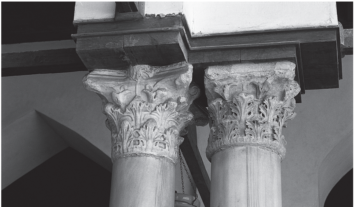
26. Chapiteaux 28 et 29, type 1, corinthiens, les volutes, à l'origine détachées, sont cassées.
