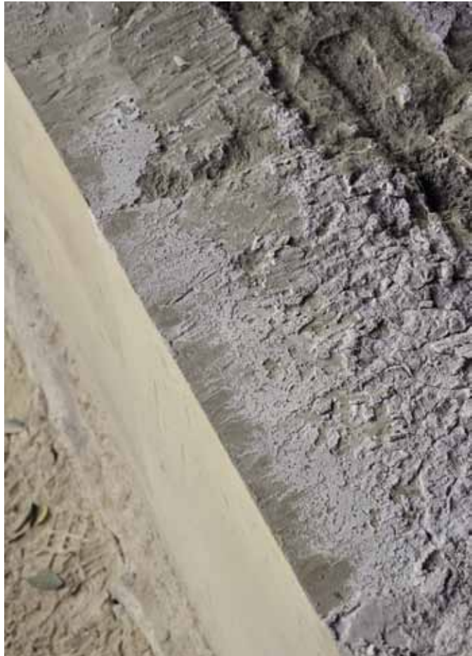
FIG. 29. Répartition du coulis sur le lit d'attente. On peut observer qu'il s'est parfaitement réparti dans le joint horizontal et comble les plus infimes dépressions du lit.
