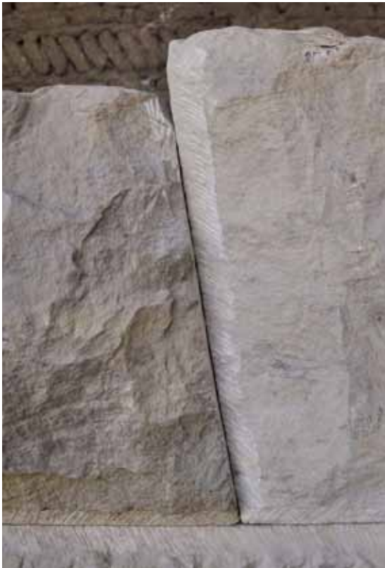
FIG. 18. État du joint avant l'ajustement par sciage.
