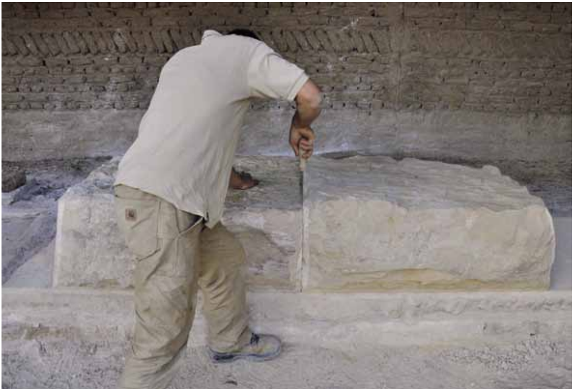
FIG. 19. Position de l'ouvrier pendant le sciage vertical. La scie, encore en position verticale, approche de la fin du joint transversal; elle va progressivement être rabattue vers une position horizontale afin de commencer sa descente dans le joint montant.
