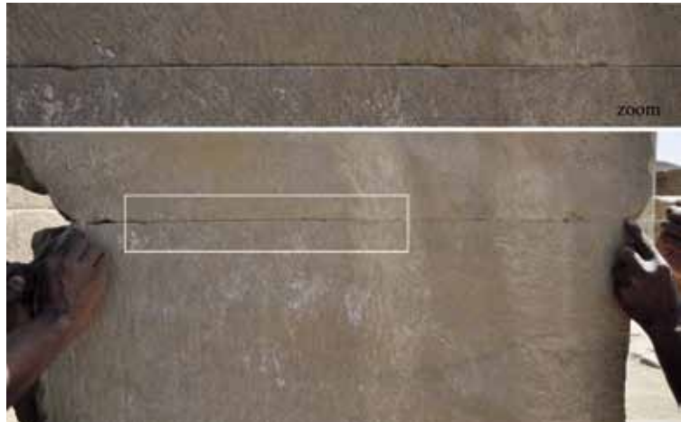
FIG. 9. Joint horizontal sinueux dans la maçonnerie du temple de l'Est à Karnak. Un fil blanc tendu met en évidence l'aspect non rectiligne du joint.
