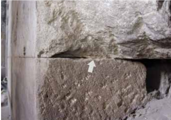
FIG. 12. Vue transversale d'un joint horizontal en l'absence d'un bloc de maçonnerie. On constate qu'il est parfaitement serré du côté du parement et qu'il s'évase légèrement à l'intérieur. La flèche entre les deux faces de joint, bien visible grâce au mortier qui a rempli l'espace, mesure ici environ 3 mm.
