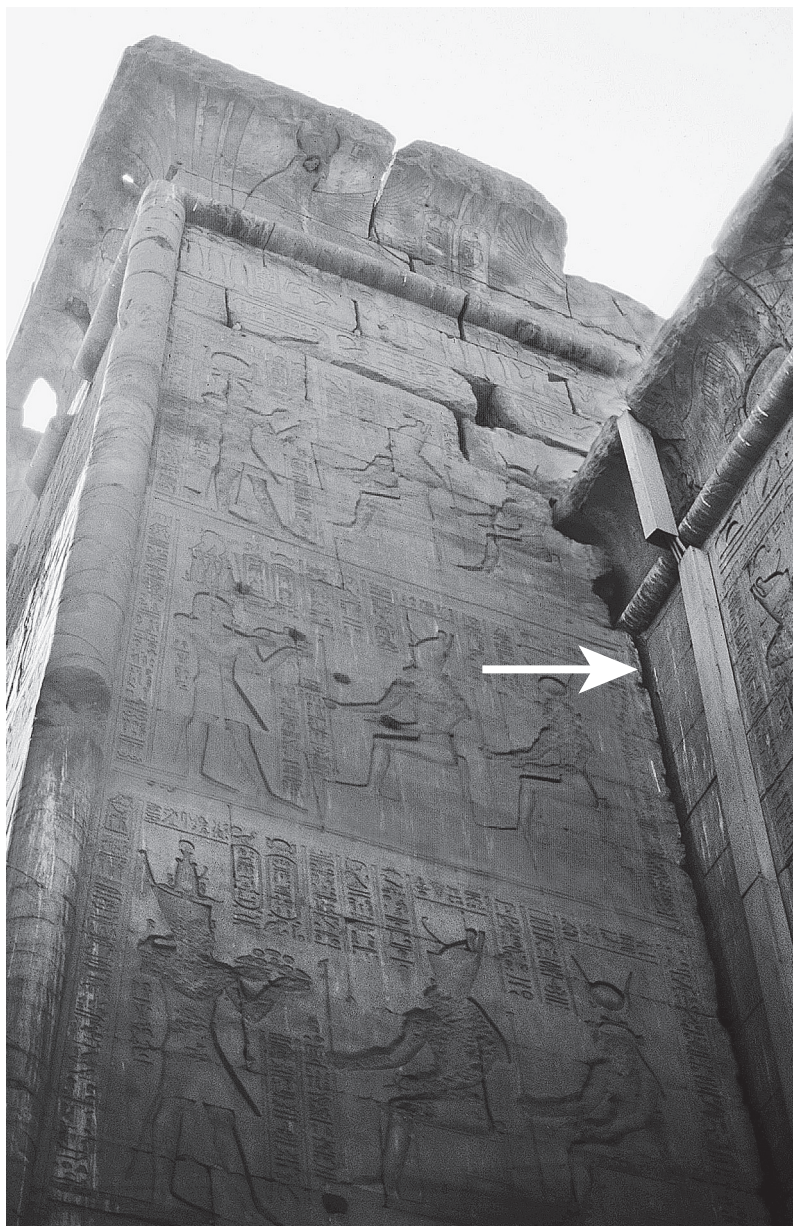
Fig. 11. Edfou, temple d'Horus. Altération du contact est naos/pronaos : la maçonnerie du pronaos s'écarte de plusieurs centimètres de celle du naos avec pour conséquence la fissuration de la corniche à l'aplomb.
